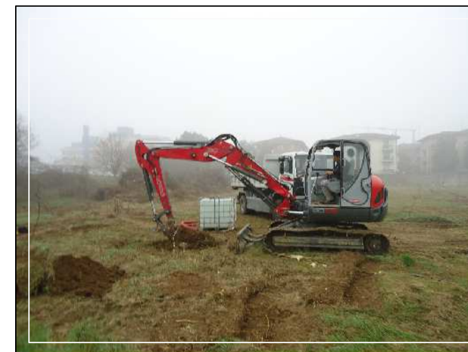
Postazione pozzetto "PP1"
