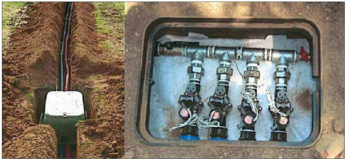
POZZETTO CON ELETTROVALVOLE IN FUNZIONE
