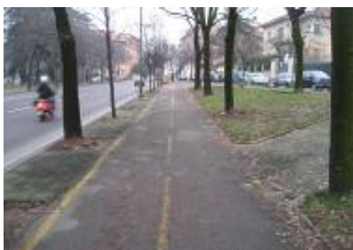
Uso di linee di margine gialle (non conformi) e degradate
